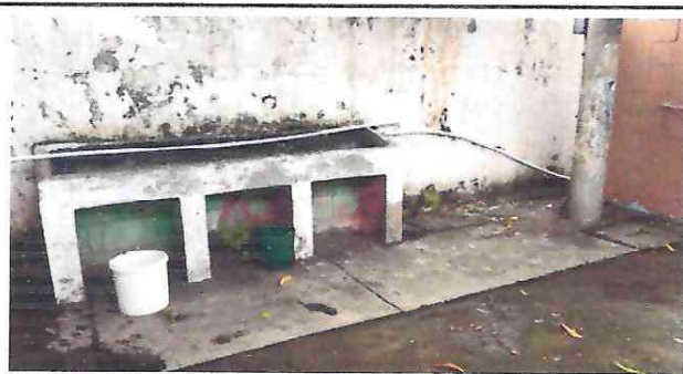
Foto 5: RED DE DRENAJE
